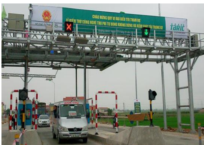
(Trạm thu phí không dừng)
