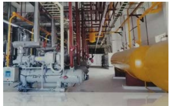
Hình 11: Hệ thống lạnh
